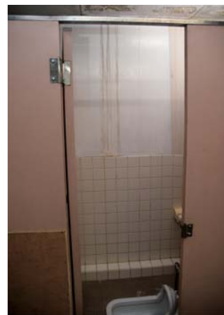
←トイレ自体の老朽化に加え、天井から雨漏り(河辺小)
