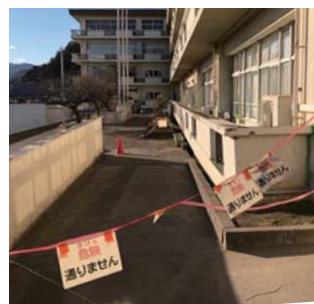
第一小の昇降口脇に「危険」の表示
