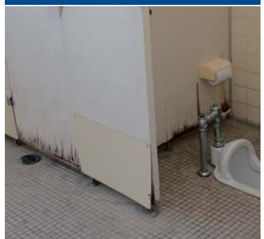
まだ改修工事が終わっていないトイレ
