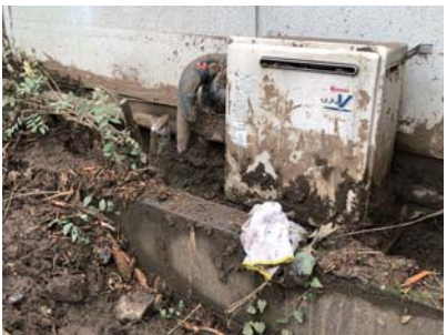
泥水で給湯機が故障
