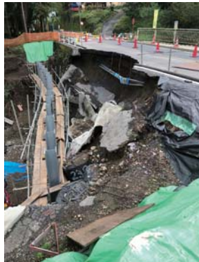
通行止めの吉野街道
